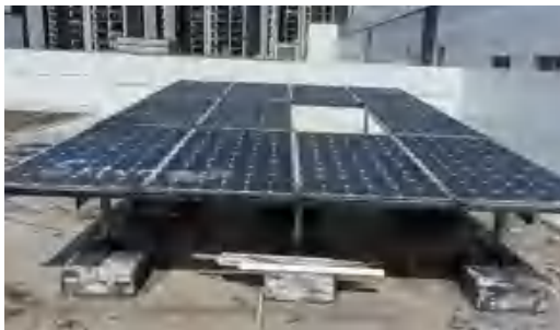
圖4-2 新加坡加拿大國際學校屋頂光伏
